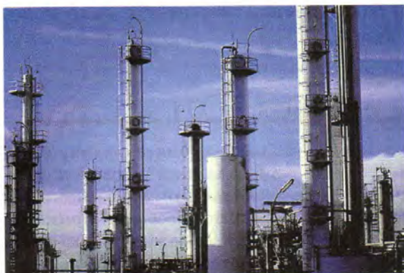
Рис. 89. Ректификационные колонны нефтеперерабатывающего завода
